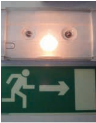
Balisage des issues de secours
