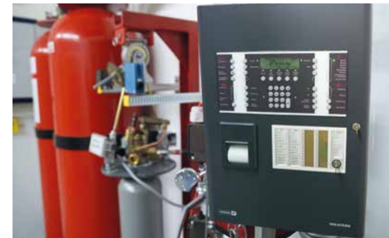
KD-1230 Löschanlage mit einer Hekatron EvoxX Brandmelder- und Löschsteuerzentrale
