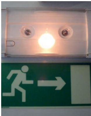
Balisage des issues de secours
